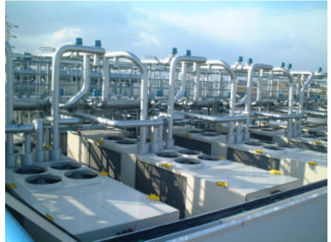
図-13. 某乳業メーカー プロセス冷却設備
