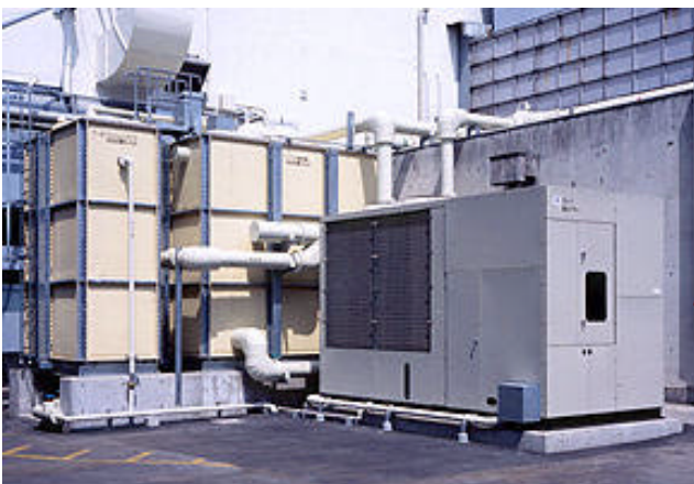
図-12. 某食品メーカー プロセス冷却設備
