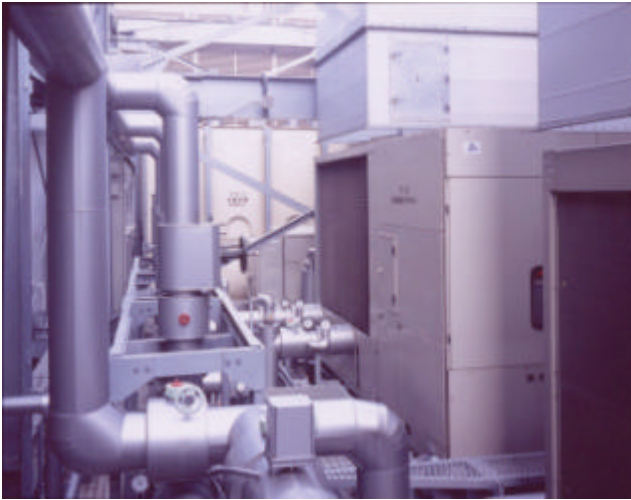
図-10. 某大学空調設備
