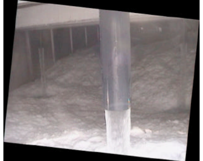
図-4. 蓄熱槽内へ氷水搬送蓄熱している様子
